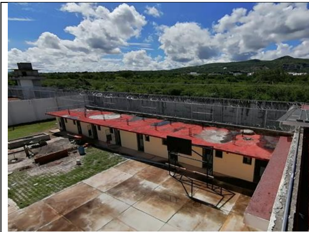
Antes de impermeabilización
