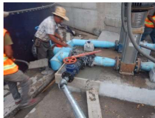
Interconexión al tanque de regularización.
