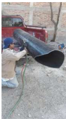
Tubería de acero para interconexión.
