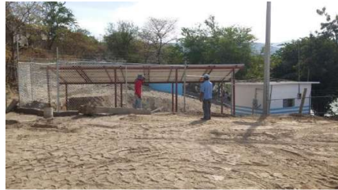
Caseta y equipo de cloración, paneles solares.
