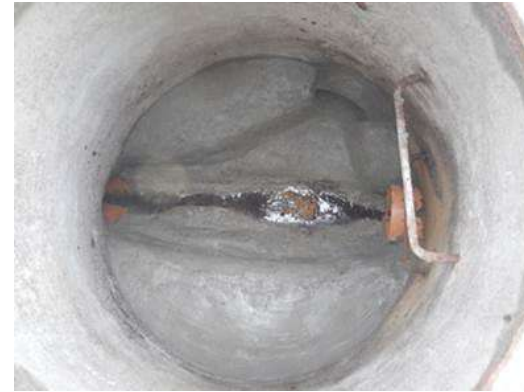
Pozos de visita.
