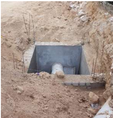
Cajas de operación de válvulas.
