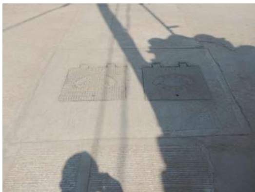
Cajas para operación de válvulas.
