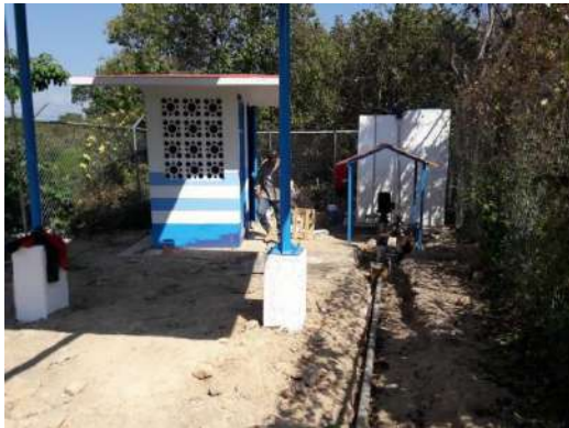
Equipamiento solar de rebombes y tanques de almacenamiento.
