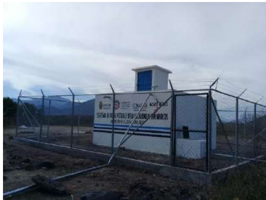
Tanque de regulación de 35 m3 y caseta de cloración, así como protección.
