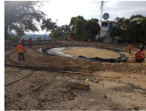
Estructura de cimentación para la colocación del tanque de almacenamiento para 1,200,000 lt.
