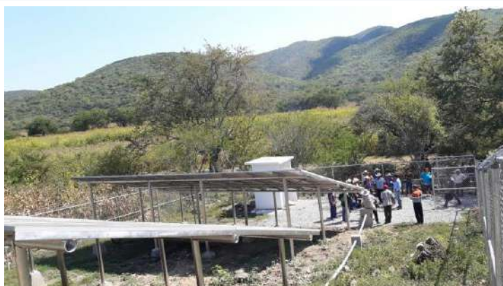
Celdas solares, caseta de controles y cerco de protección.
