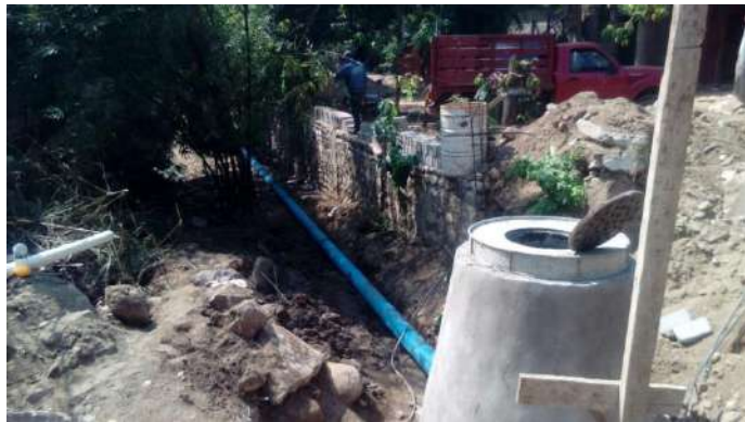
Red de atarjeas tubería de acero y pozos de visita.
