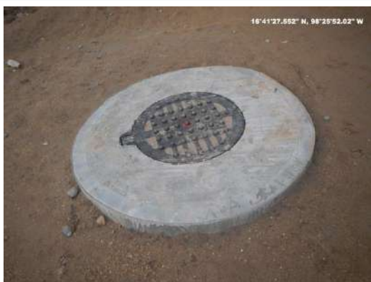
Pozos de visita.
