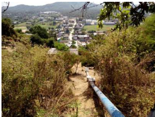
Línea de conducción tubería de acero y atraques.
