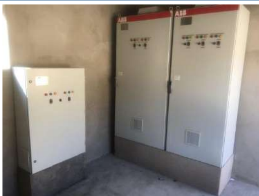
Subestación eléctrica en la PTAR.
