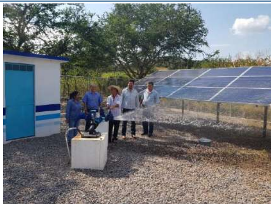
Equipamiento electromecánico, electrificación, cercado perimetral en la captación y caseta de controles.
