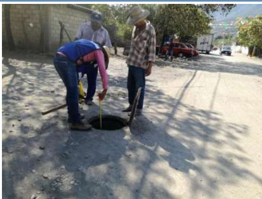
Pozos de visita en la red de atarjeas.
