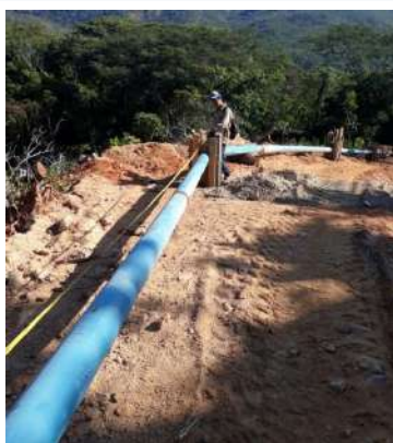
Línea de conducción tubería de acero de 6".
