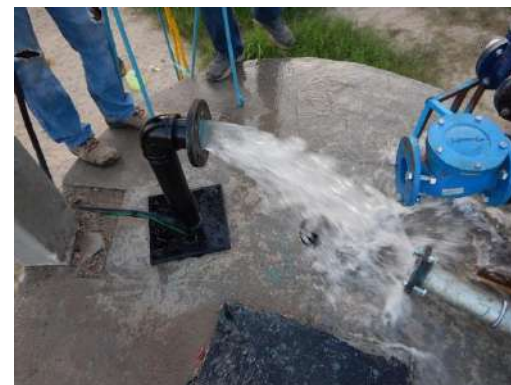
Pozo existente 1 y equipamiento.
