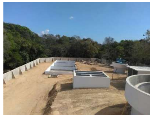
Planta lodos activados, espesador de lodos y sedimentador secundario.
