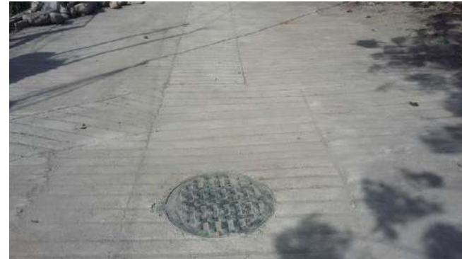
Pozos de visita.
