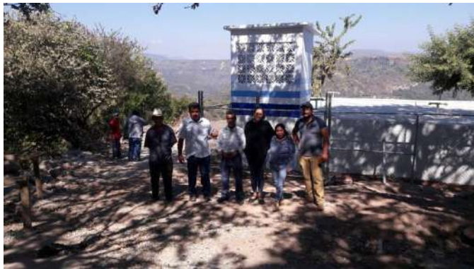
Tanque de regularización de 150 m 3 y caseta de cloración.
