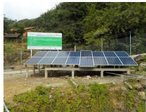
Equipamiento solar en la captación.
