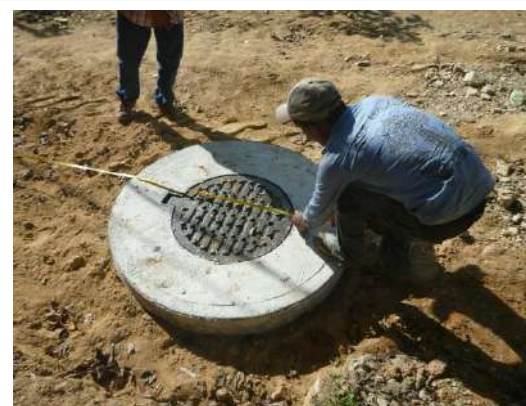
Pozo de visita.
