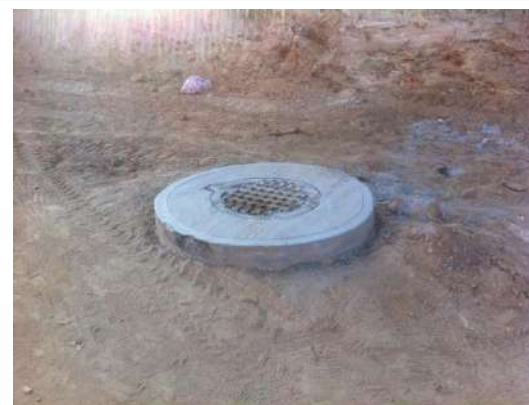
Pozos de visita.
