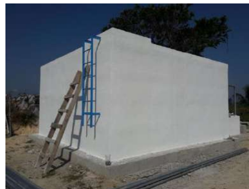
Tanque de regularización funcional.
