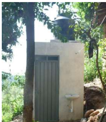
Sanitario digno con biodigestor.
