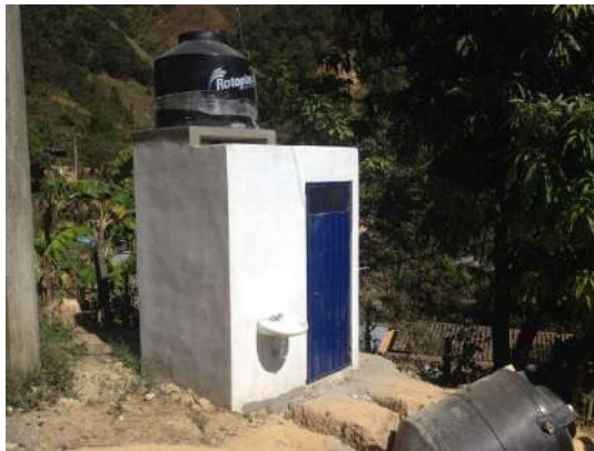
Sanitario digno con biodigestor.
