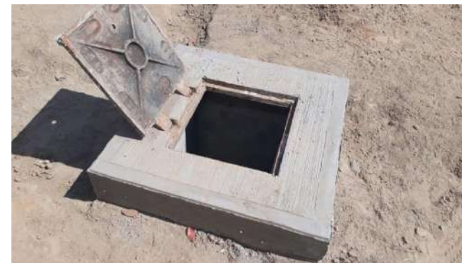
Cajas en alcantarillado sanitario.
