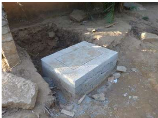
Cajas en alcantarillado sanitario.
