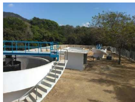
Espesador de lodos y sedimentador secundario.
