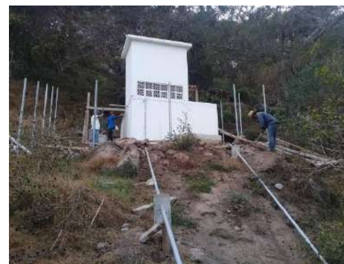
Tanque de regularización de 20 m3 y caseta.
