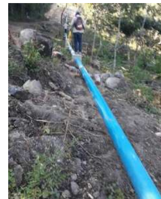
Línea de conducción tubería de acero de 6".
