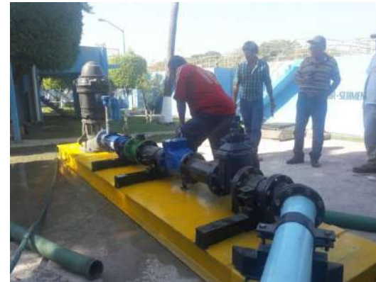
Bombeo planta potabilizadora.
