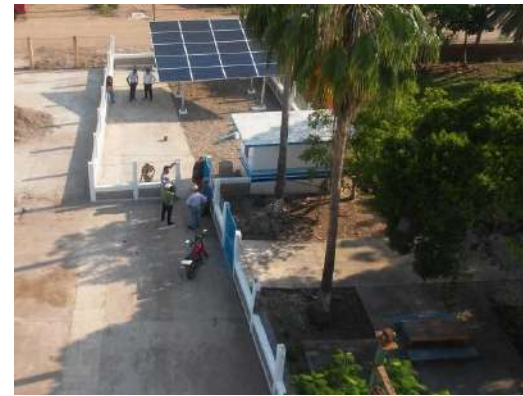
Equipamiento solar captación y cerco de protección.
