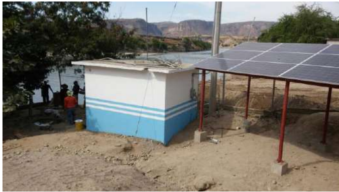
Caseta y equipo de cloración, paneles solares.
