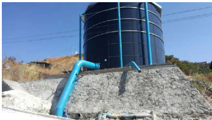
Tanque superficial pre fabricado de 700 m3.
