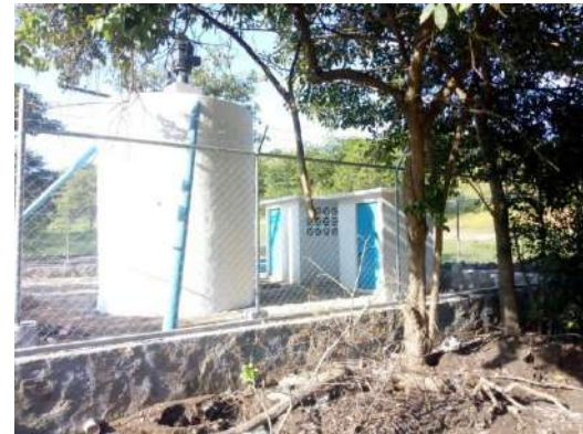
Equipamiento electromecánico del cárcamo de rebombeo.
