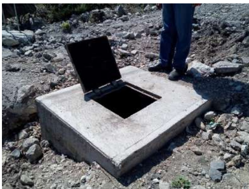
Cajas para operación de válvulas.
