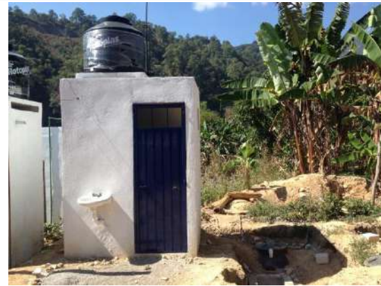
Sanitario digno con biodigestor.
