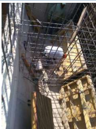
Cimbrado en las estructuras de la PTAR.
