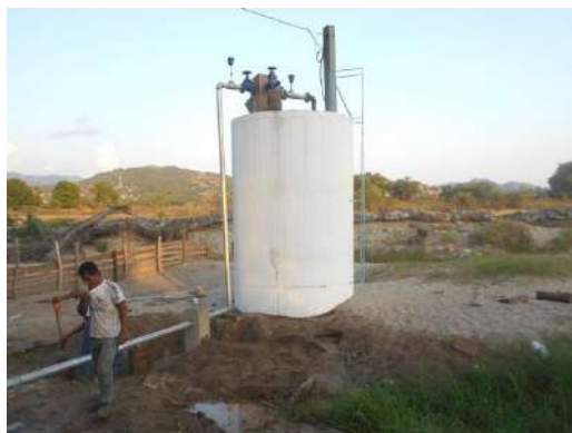
Pozo existente 1 y equipamiento.
