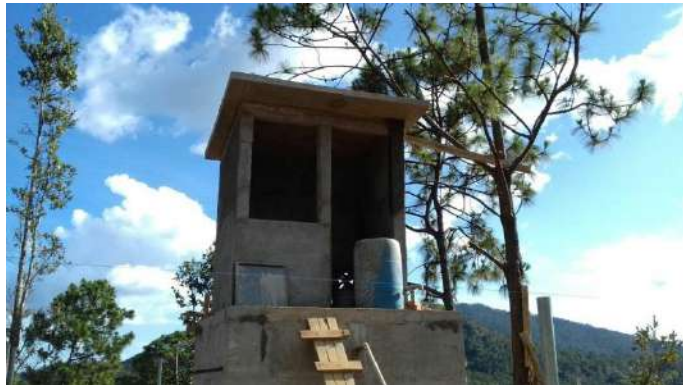
Tanque de regularización de 10 m3, caseta de cloración y cercado perimetral.
