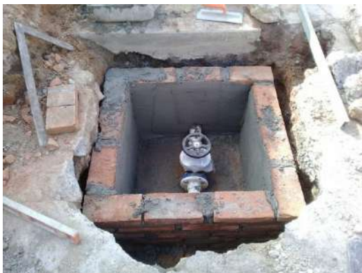
Cajas de operación de válvulas.
