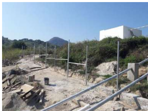
Cercado en el tanque de regularización funcional.
