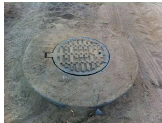
Pozo de visita.
