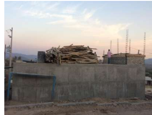
Tanque de 500 m3 y caseta de control cárcamo de bombeo planta potabilizadora.
