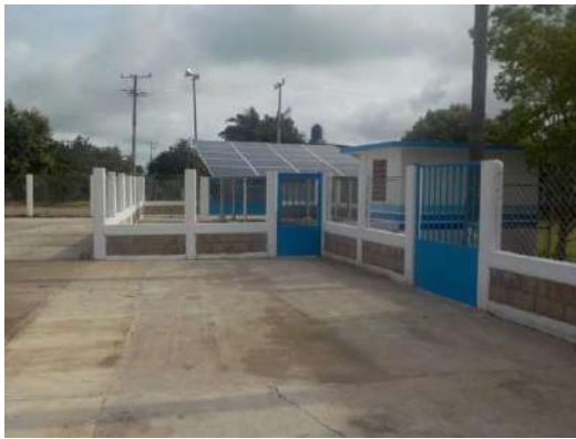
Equipamiento solar captación y cerco de protección.
