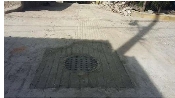
Pozos de visita.
