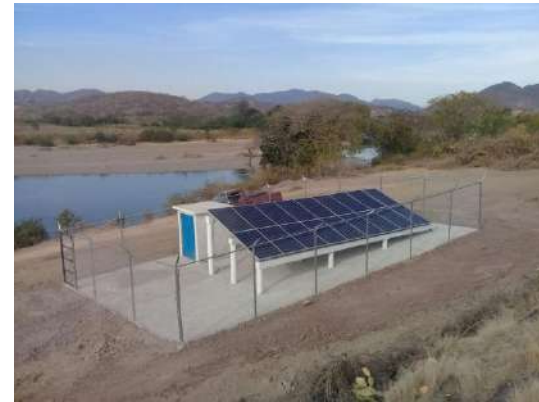
Sistema de bombeo fotovoltaico.
