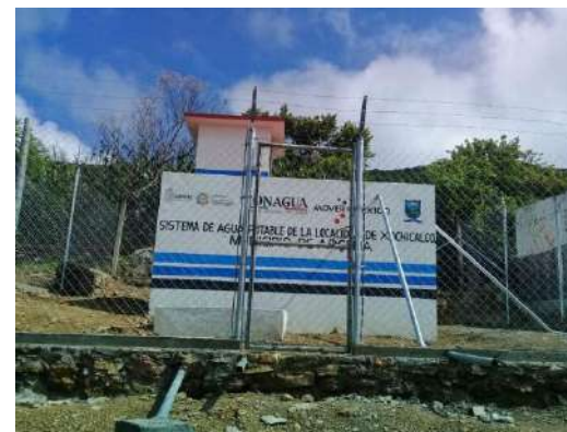
Tanque de regulación y caseta de cloración .
