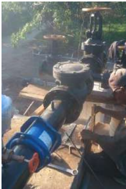
Equipamiento electromecánico del cárcamo de rebombeo.
