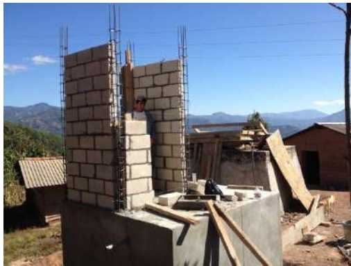
Caseta de control.
