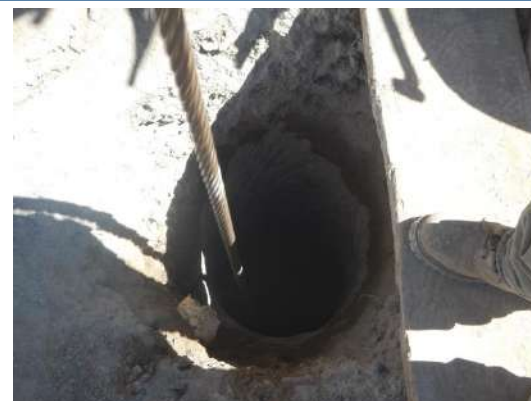
Se perforo a los 170 m, se realizó video no se encontró agua.
