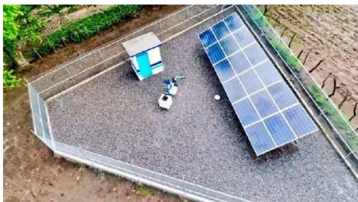
Equipamiento electromecánico, electrificación, cercado perimetral en la captación y caseta de controles.
