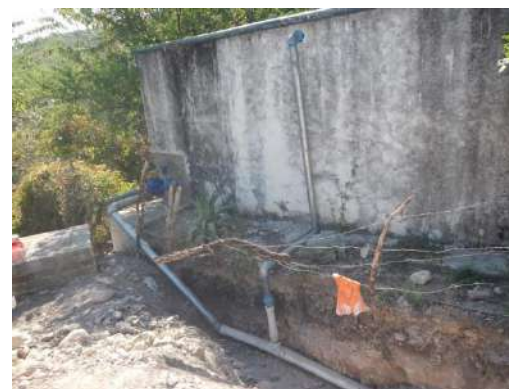
Interconexión al tanque.
