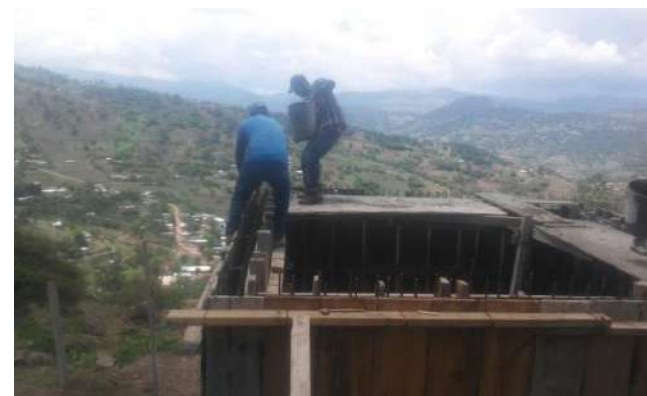
Tanque de regularización de 30 m3.
