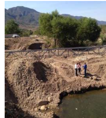
Armado para cruce de la tubería de acero del colector en el río.
