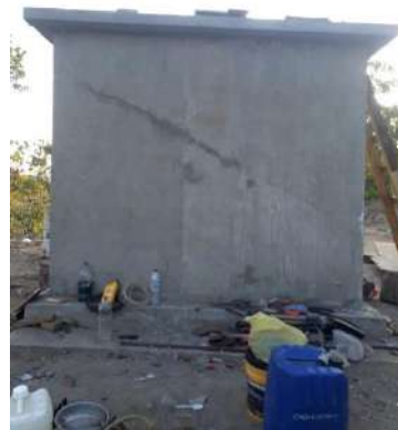
Tanque de cambio de régimen.
