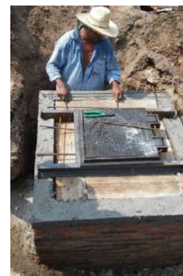
Caja para operación de válvulas.
