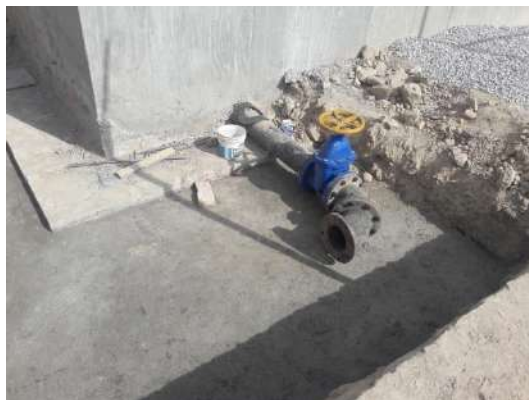
Interconexión al tanque.
