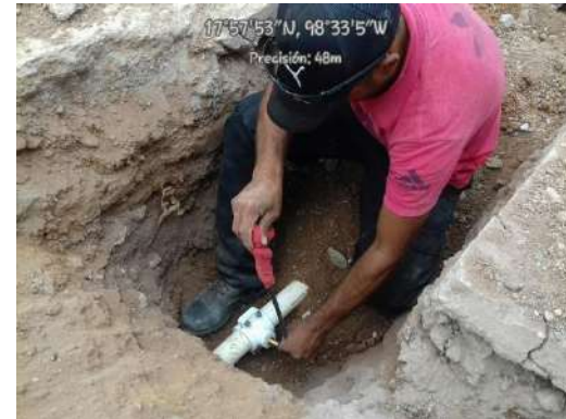
Interconexión para toma domiciliaria.
