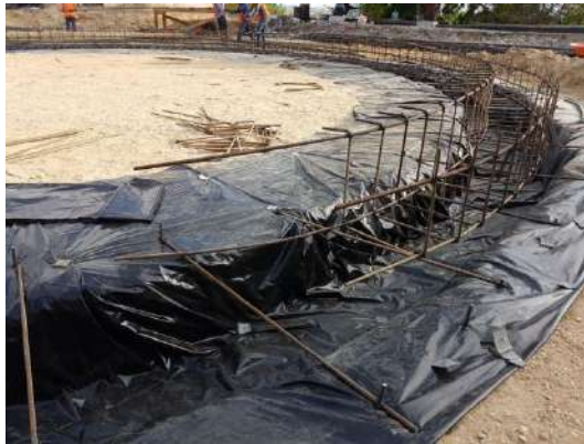
Estructura de cimentación para la colocación del tanque de almacenamiento para 1,200,000 lt.
