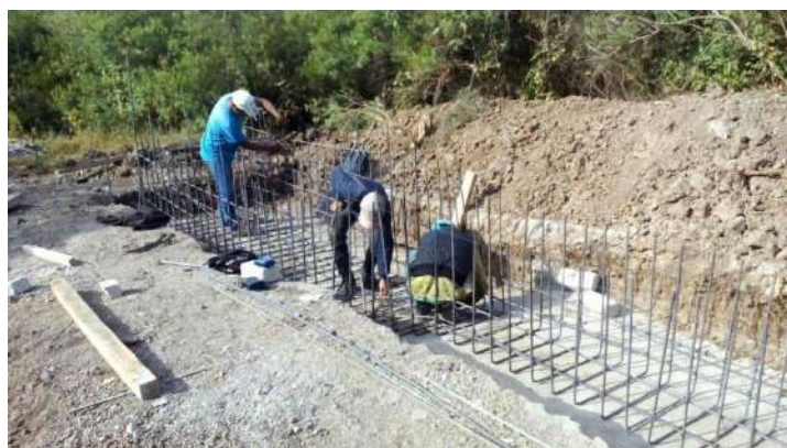
Habilitado de acero en tanques de contacto de cloro para conjunto en fosas.
