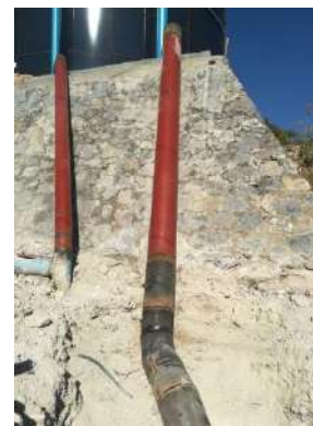
Interconexión al tanque de 700 m3.
