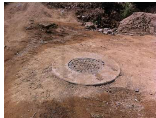
Pozo de visita.
