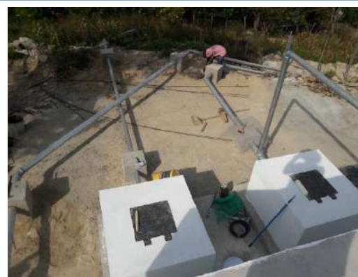
Cajas para operación de válvulas.
