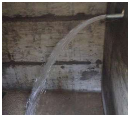
Tanque de almacenamiento (capacidad 40 m3).
