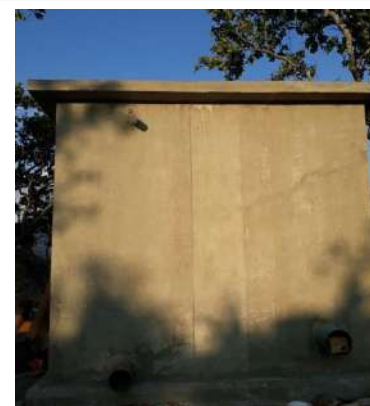
Tanque de cambio de régimen.
