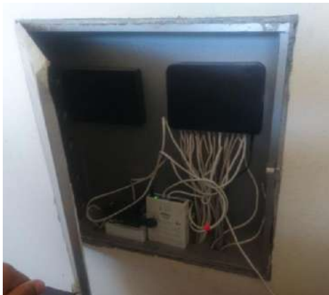
Foto 4.- Mantenimiento en la red institucional.
