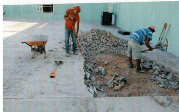
INICIO DE TRABAJOS DE CIMENTACIÓN PARA LA COLOCACIÓN DE LA TORRE Y ENLACE DE TELECOMUNICACIÓN.
