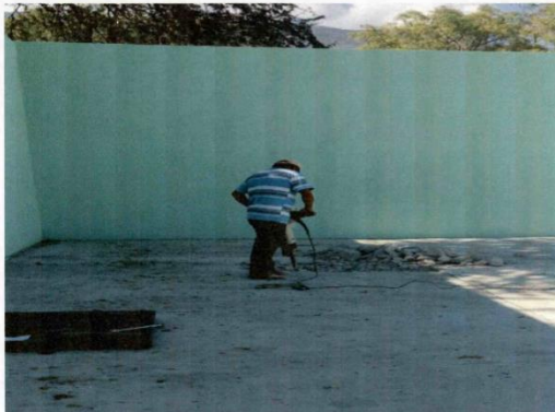
INICIO DE TRABAJOS DE CIMENTACIÓN PARA LA COLOCACIÓN DE LA TORRE Y ENLACE DE TELECOMUNICACIÓN.
